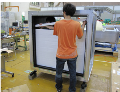
図 8.2 トラッキングプレーン用 シンチレータの取り付け
